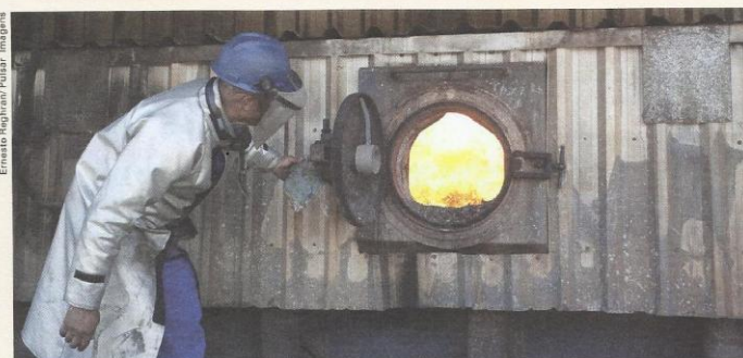
Figura 4.5: Caldeira de uma usina termelétrica em Maringá (PR). Foto de 2013.
