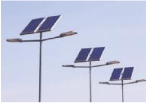
Postes de luz elétrica com painel fotovoltaico
