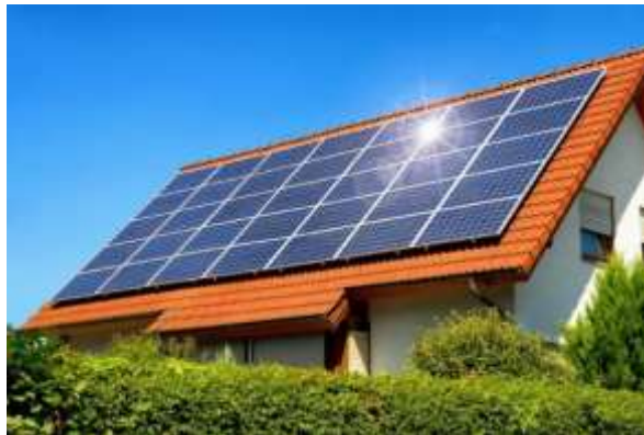
Figura 14 – Painéis solares que são utilizados para a transformação de energia solar fotovoltaica em energia elétrica.
