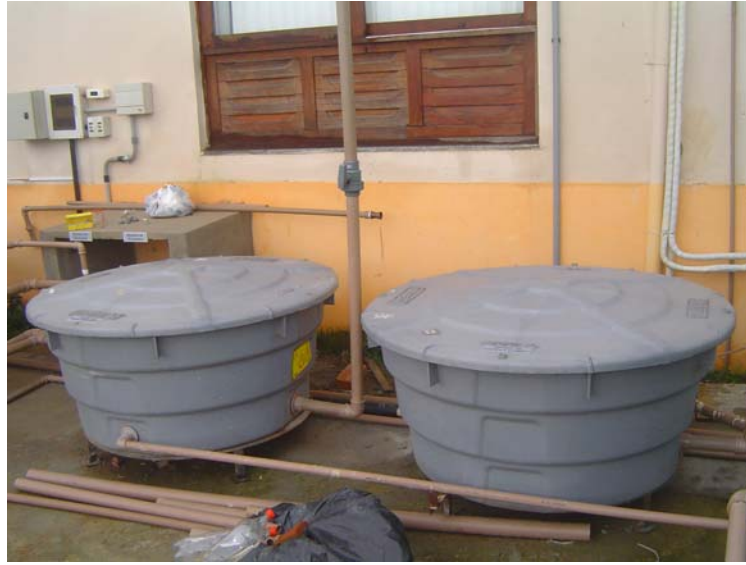
Figura 14 – Tanques de água decantada e água de fora de especificação (respectivamente)
