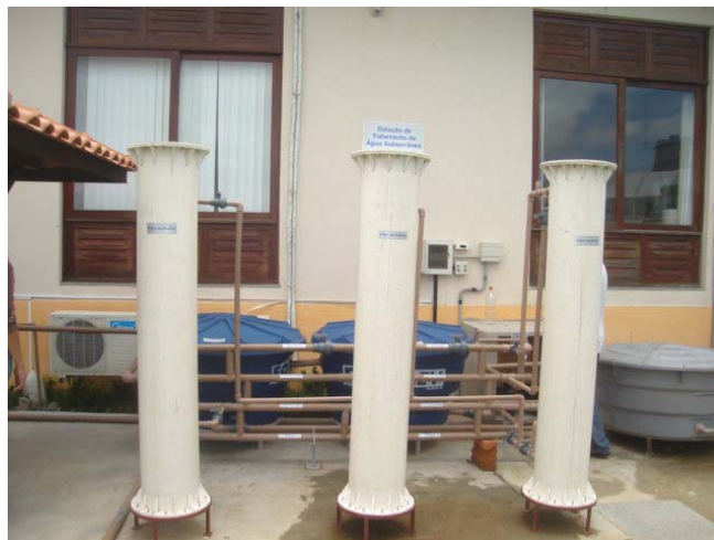
Figura 23 – Estação de tratamento de água subterrânea
