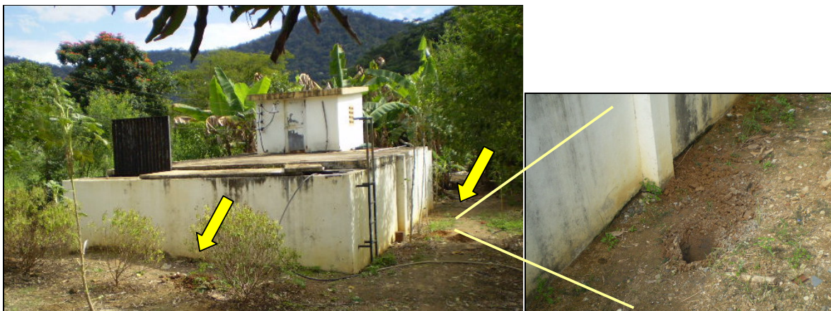
Figura 11: Pontos de coleta de solo na ETE do bairro Piteira.
