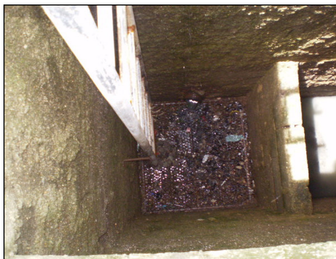
Figura 24: Caixa de gradeamento da ETE
