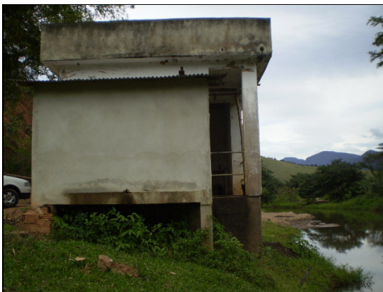
Figura 5: Casa de bombas para captação de água
