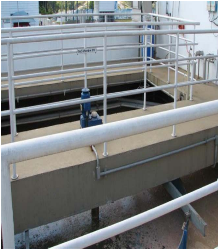
Ilustração 81 - Tecnologia de Tratamento Aeróbio implantado na Beiersdorf/Nívea – Itatiba, São Paulo Fonte: Envirochemie, 2008
