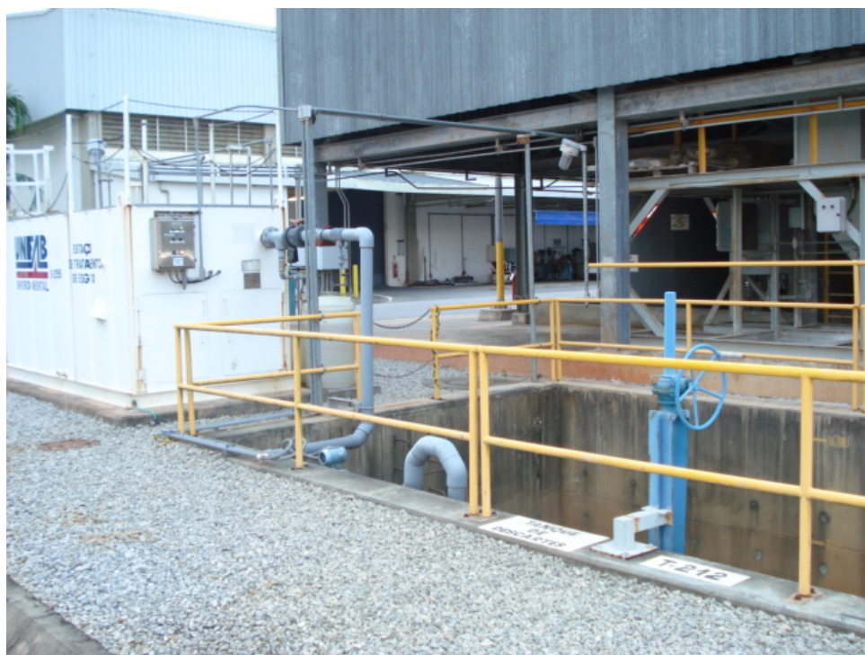
Ilustração 8 - Registro Fotográfico de Campo Apresentando o Sistema de Tratamento de Esgoto e o Tanque de Saída Geral dos Efluentes da UTE Mário Lago Fonte: MATOS, 2008
