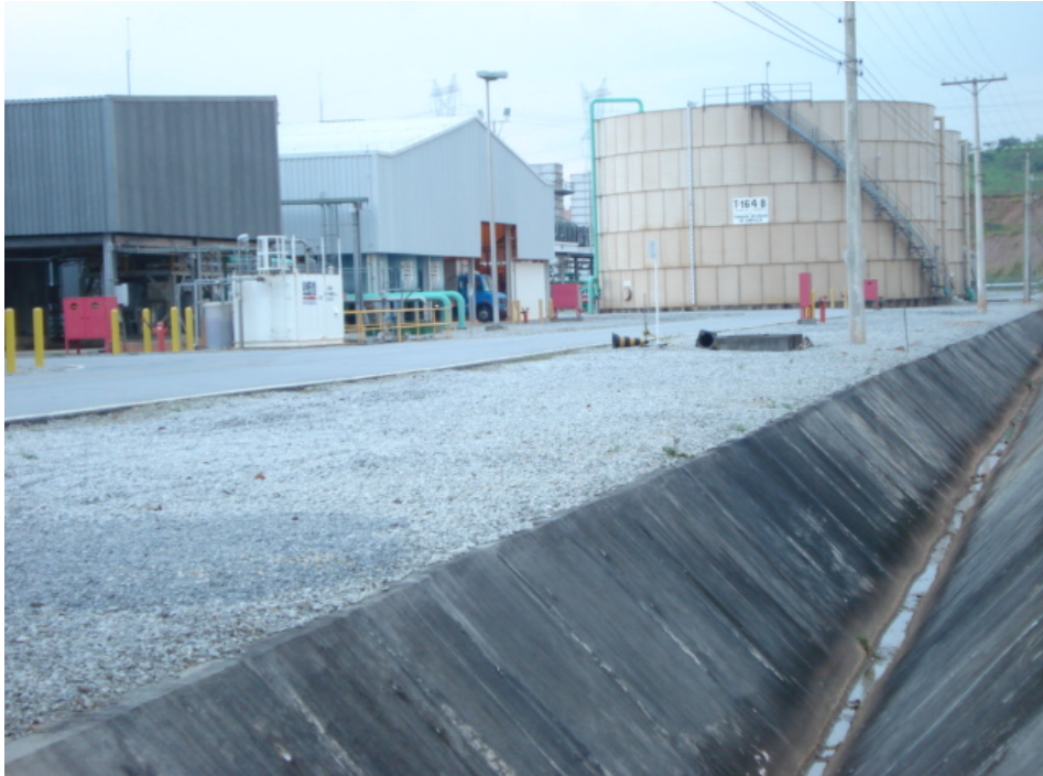
Ilustração 6 - Vista Geral da Estação de Tratamento de Água da Usina, Sistemas de Clarificação, Desmineralização, Tratamento de Efluentes e Canaleta de Drenagem Pluvial. Fonte: MATOS, 2008
