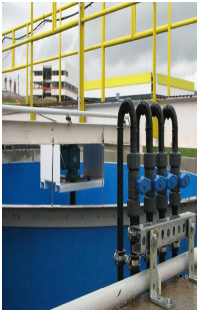
Ilustração 83 - Tecnologia de Tratamento de Neutralização, Tratamento aeróbio e Filtração implantado na Eurofarma - Itapevi, São Paulo Fonte: Envirochemie, 2008
