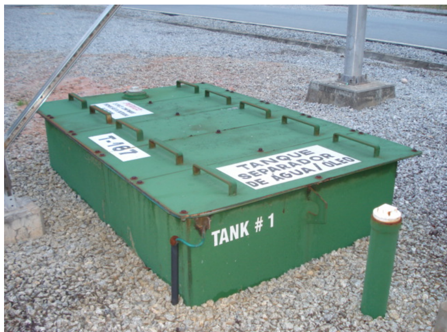
Ilustração 9 - Registro Fotográfico do Separador de Água e Óleo da ETA
