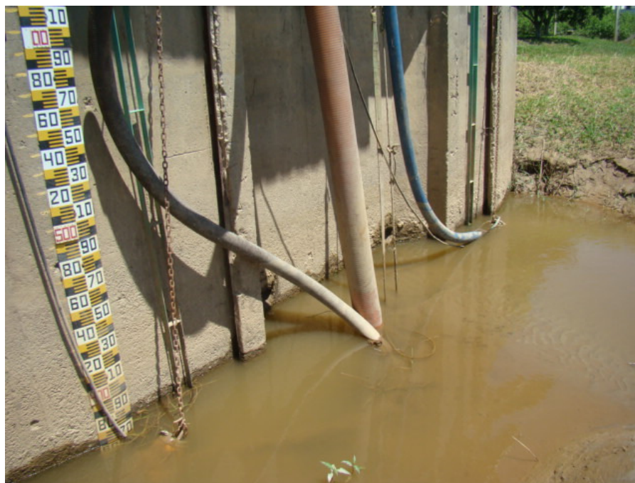
Figura 8: Assoreamento dos pontos de captação de água em Macaé. Fonte: Elaboração Própria, 2009.
