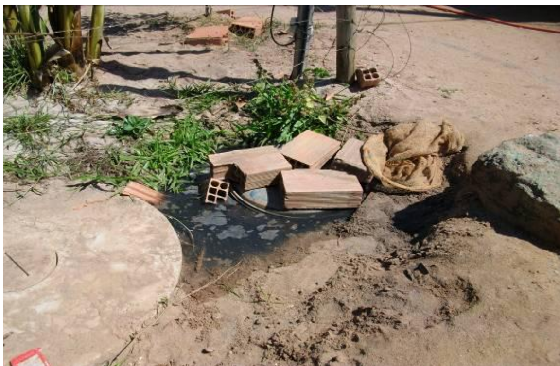
Figura 3 – Vazamento de efluente doméstico
