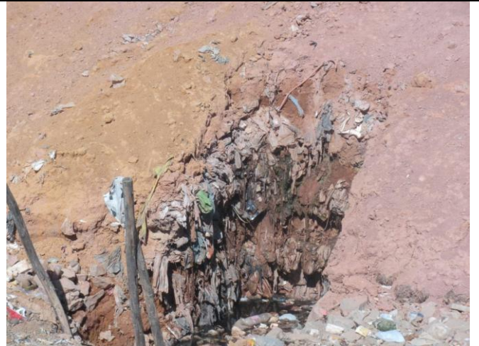
Figura 33: Aterro de Cabiúnas. . Maciço de lixo apresentando regiões com acumulação de chorume ocasionando erosões. Área de transbordo. Fonte: Fotos da Autora (2009).
