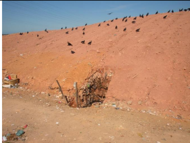
Figura 32: Aterro de Cabiúnas. Maciço de lixo apresentando regiões com acumulação de chorume ocasionando erosões. Fonte: Fotos da Autora (2009).
