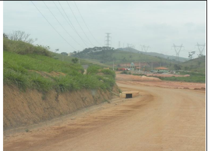
Figura 41: Sistema de drenagem de águas pluviais na via de acesso. Fonte: Fotos da Autora (dez, 2009).
