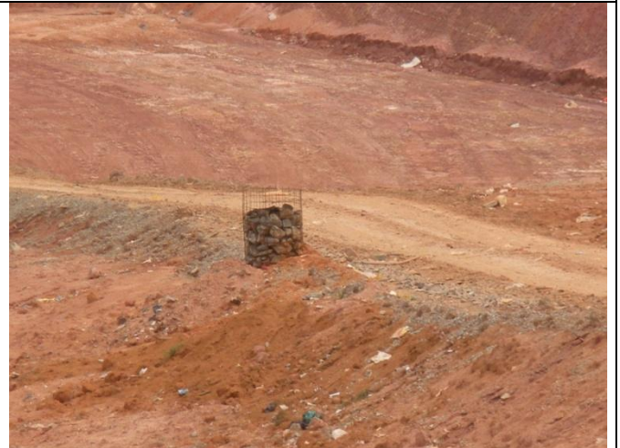
Figura 43: Sistema de drenagem de gases. Fonte: Fotos da Autora (dez, 2009).
