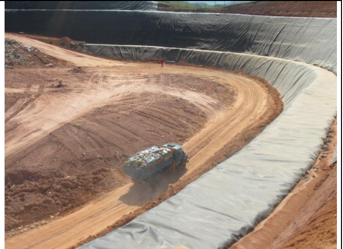
Figura 51: Caminhão efetuando o transporte dos RSU, com carga coberta. Fonte: Fotos da Autora (mai, 2009).
