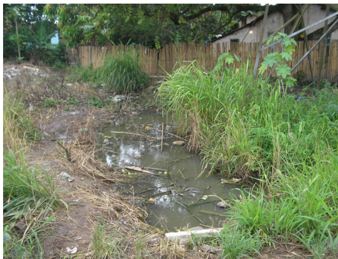
Figura 24: Esgoto correndo a céu aberto próximo às casas na comunidade de Santa Cruz, em Campos dos Goytacazes (RJ).
