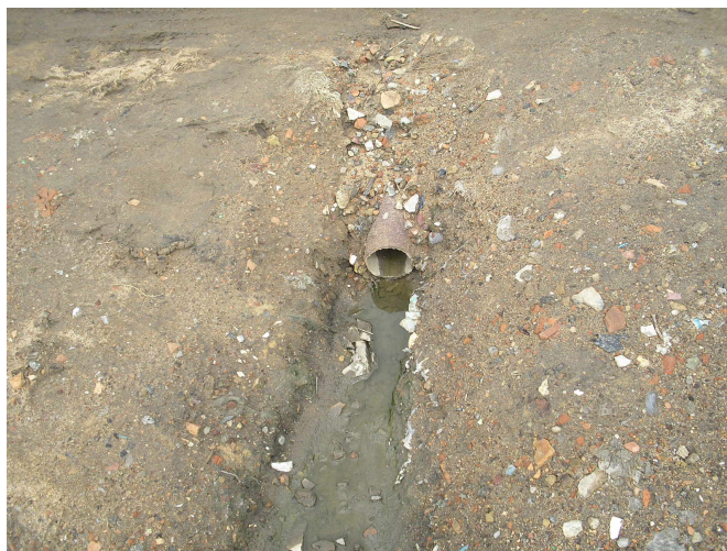
Figura 25: Condições precárias de saneamento básico, com despejo de esgoto diretamente nas ruas da comunidade de Santa Cruz, em Campos dos Goytacazes (RJ).
