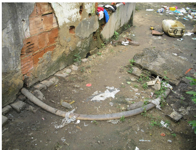
Figura 20: Precárias instalações de coleta de esgoto, em casa da comunidade de Santa Cruz, em Campos dos Goytacazes (RJ).
