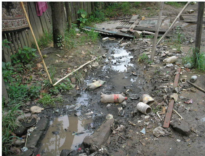
Figura 23: Vazamento de esgoto no quintal de uma casa na comunidade de Santa Cruz, em Campos dos Goytacazes (RJ), devido o transbordamento da fossa do domicílio.
