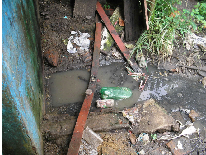
Figura 22: Condições precárias de saneamento básico (Fossa transbordando no quintal) nas residências da comunidade de Santa Cruz, em Campos dos Goytacazes (RJ).
