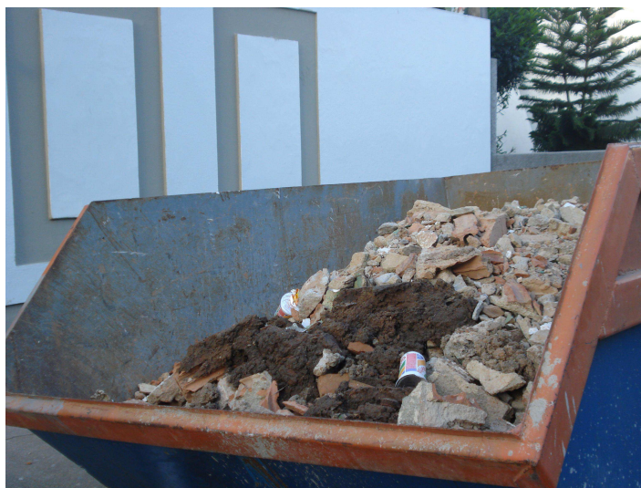
Figura 18 – Caçamba sem triagem dos resíduos (Junho 2010).
