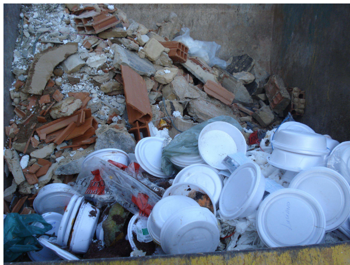
Figura 17 – Caçamba com RCC misturado a outros tipos de resíduos em canteiro de obras (Agosto 2010).
