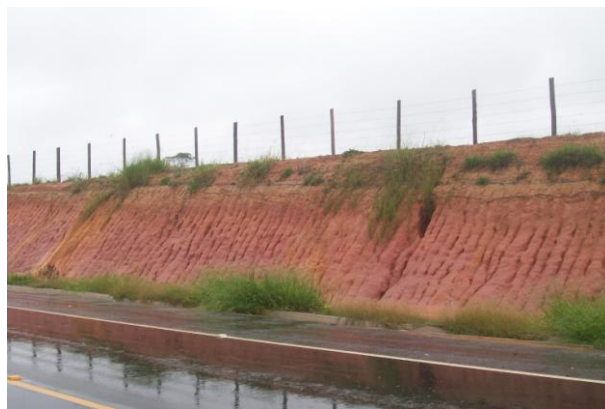
Foto 14: Erosão em sulcos na Estrada do Contorno, Rio das Ostras – RJ, 2008. Fonte: M. L. M. GOMES, 2008
