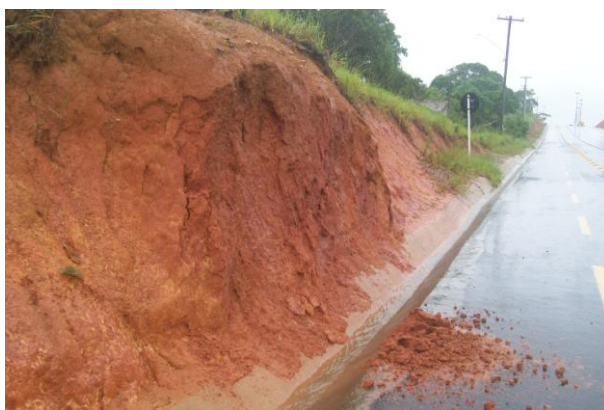
Foto 13: Solo em processo erosivo, Anel Viário, Rio das Ostras – RJ, 2008.
