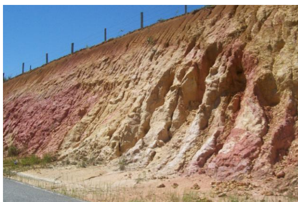
Foto 1: Talude e corte de estrada com exposição de solo, Estrada do Contorno – Rio das Ostras. Autoria: M.L.M. GOMES, 2008.
