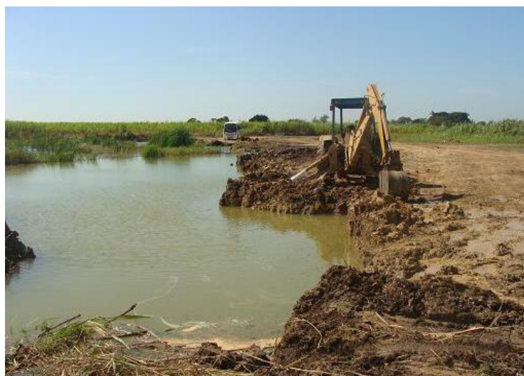
Figura 10 – Preenchimento de água do lençol freático em cava em processo de extração. Foto: do autor.
