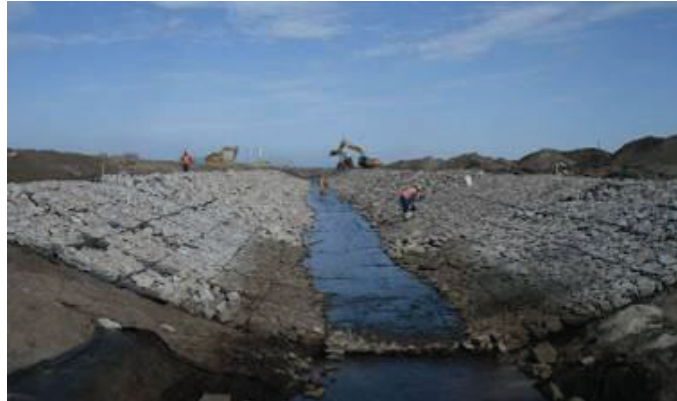
Figura 4 – Canal de drenagem: estaleiro da OSX. Fonte: Roberto Moraes, 2012.
