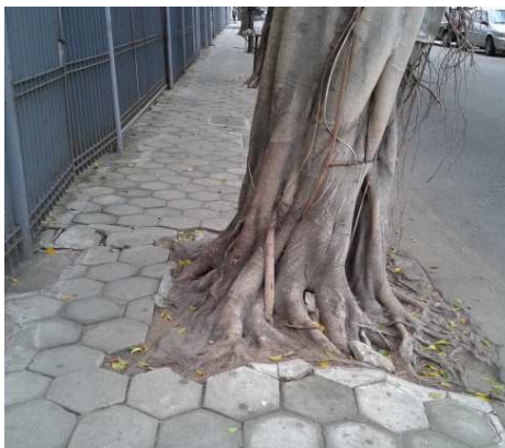
Figura 4: Árvores inapropriadas que danificam a calçada e comprometem a acessibilidade, na Rua Câmara Júnior.
