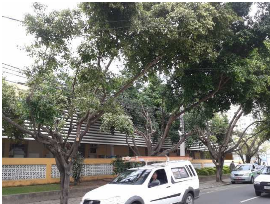
Figura 2: Árvores em conflito com a rede elétrica em frente ao Hospital Escola Álvaro Alvim, na Rua Barão da Lagoa Dourada.
