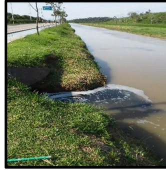
FOTO 6 – Esgoto doméstico FONTE: Próprios autores
