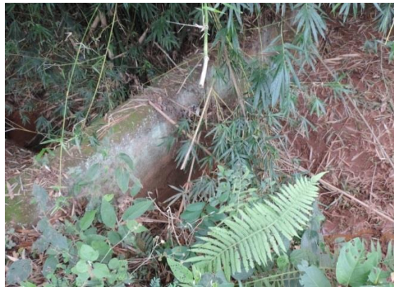
Figura 10 - Barreira de cimento da nascente 4.
