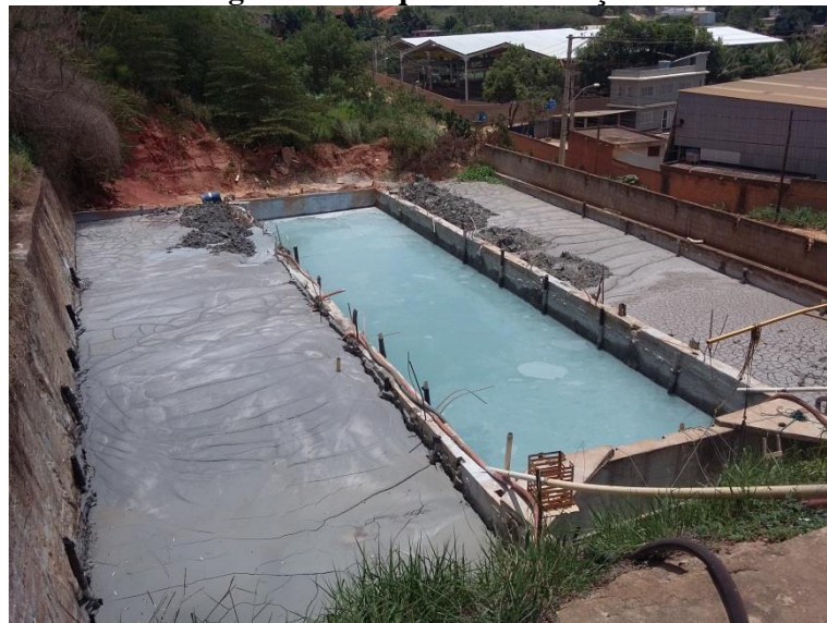
Figura 2- Tanque de decantação.
