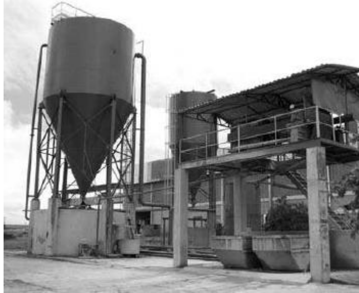
Figura 13- Decantador vertical acoplado ao filtro prensa.
