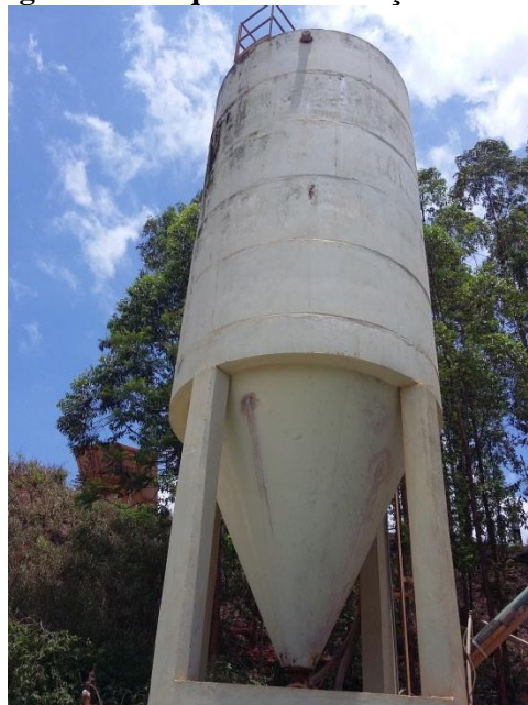
Figura 4- Tanque de decantação vertical.
