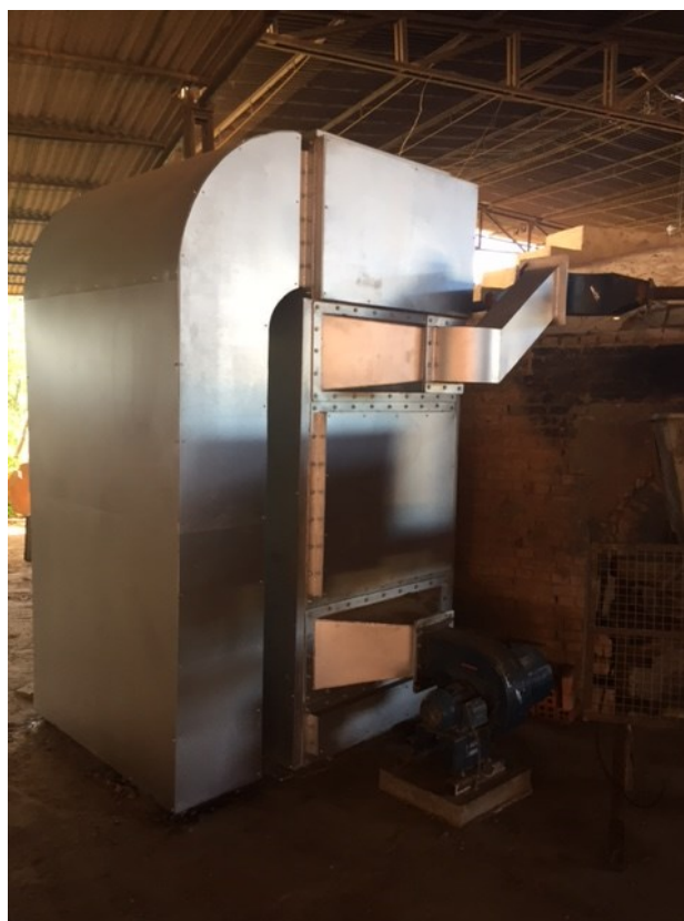
Figura 1. Trocador de calor instalado no forno abóbada
