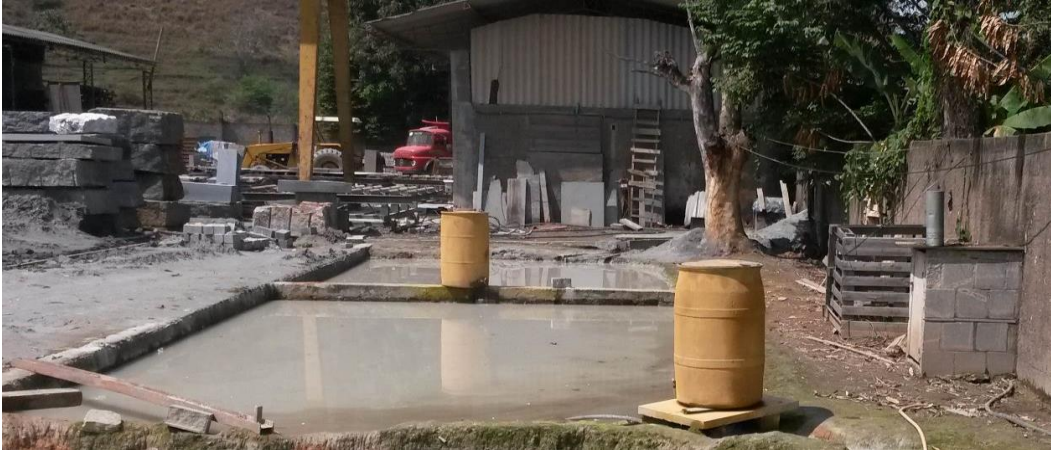
Figura 7 – Ponto 3: Segundo Tanque de decantação
