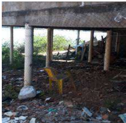
Figura 13: residências na área de nível máximo da Lagoa e entulhos de construções
