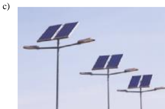
Postes de luz elétrica com painel fotovoltaico
