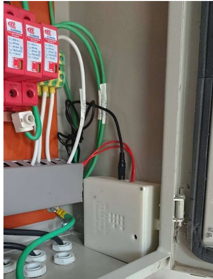
Figura 55 - Montagem do dispositivo no inversor 4
